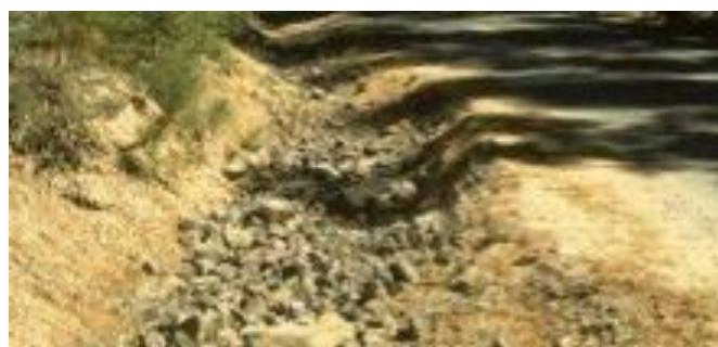
Figure 5.145: Fossé protégé en bordure de route avec des roches calibrées (enrochement) pour le contrôle de l'érosion.
