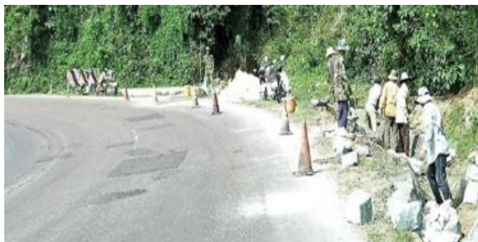
Figure 3.51: Absence totale de vêtements de protection pour les ouvriers sur la route ou de délimitation adéquate du chantier.
