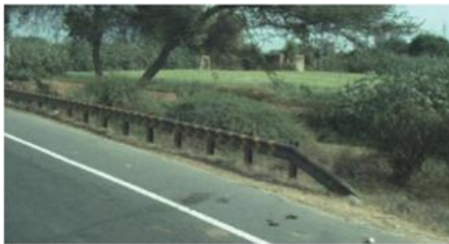
Figure 5.88: Extrémité rampante non sécurisée d'une glissière semi-rigide qui peut projeter un véhicule percutant.
