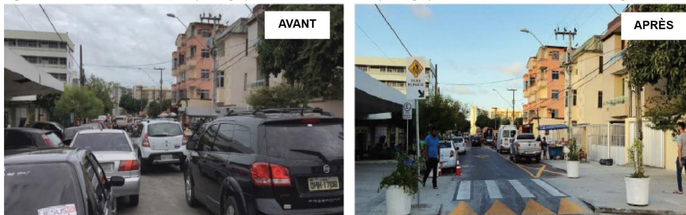
Figure 4.27: Transformation d'un passage piéton inexistant en un passage piéton surélevé bien défini avec signalisation.
