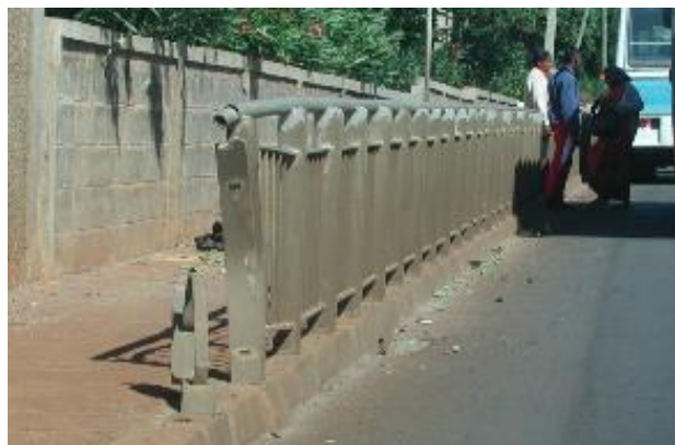
Figure 4.10: Glissière de sécurité pour piétons mal entretenue – Inspection de la maintenance.
