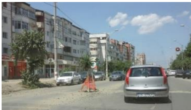
Figure 3.50: Construction sans protection ou séparation du chantier et de la circulation générale – Roumanie.
