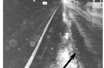
Figure 5.131: Bord du revêtement partiel de la chaussée entraînant une rétention d'eau en surface
