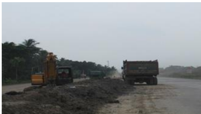
Figure 3.48: Le chantier se poursuit sans aucune mesure de sécurité temporaire – Bengale-Occidental.
