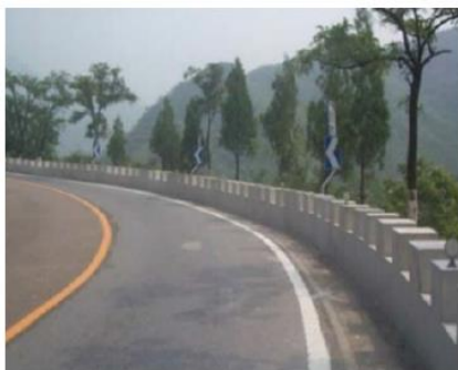
Figure 5.35: Glissière en béton dans la section de la courbe avec des panneaux d'alignement en chevron.
