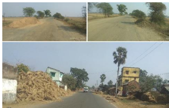
Figure 3.53: Matériaux de construction empilés sans protection ni séparation le long de l'autoroute – Inde
