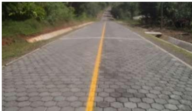
Figure 5.121: Revêtement en blocs de béton (adoquins) en bon état et installations de drainage appropriées.
