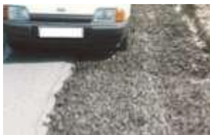
Figure 5.127: Drainage fermé rempli de matériaux poreux pour éviter l'érosion et la chute.
