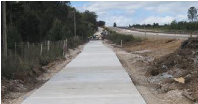
Figure 4.12: Infrastructure de transport séparée pour les piétons/usagers non motorisés sur une route rurale..
