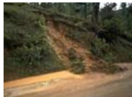
Figure 5.137: Matériaux de glissement bloquant les fossés de drainage.
