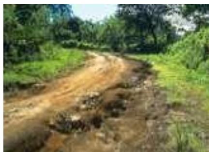
Figure 5.135: Route mal drainée avec une surface de conduite rugueuse (source des sédiments).
