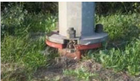
Figure 5.169: Colonne d'éclairage à patins adaptée aux routes à grande vitesse avec peu d'activité piétonne et de stationnement.
