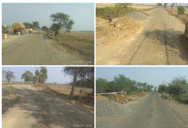
Figure 3.52: Chantiers et matériaux non protégés – Inde
