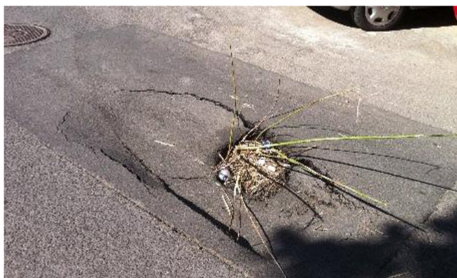
Figure 3.54: Revêtement routier mal entretenu – Roumanie.
