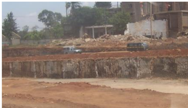
Figure 3.49: Excavation importante sans protection ni séparation du chantier et de la circulation générale – Kenya.
