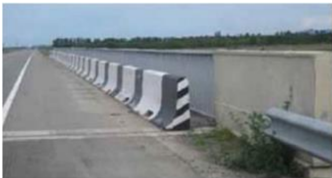
Figure 5.89: Espace dangereux entre la glissière de sécurité et le béton
