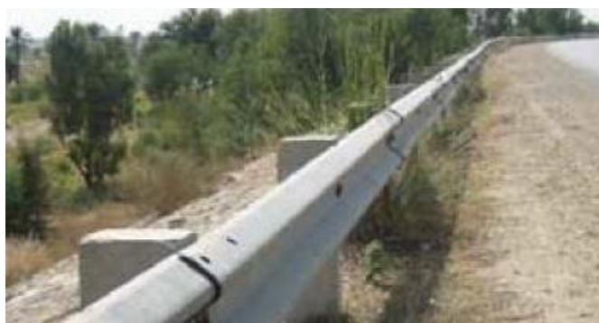
Figure 5.84: Les rails se chevauchent dans le mauvais sens
