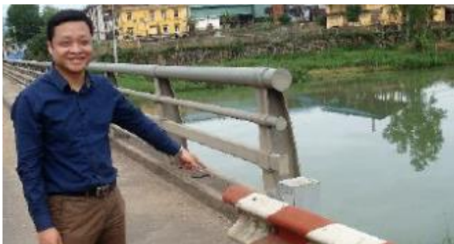
Figure 5.87: L'extrémité exposée de la glissière de sécurité peut transpercer un véhicule en cas d'impact.
