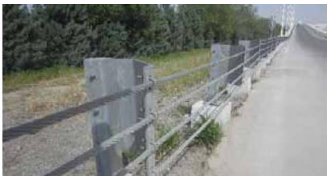
Figure 5.83: Glissières souples avec des poteaux trop grands.
