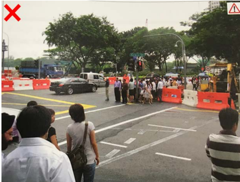
Foto 5.7. Penyeberangan Tidak Memadai
