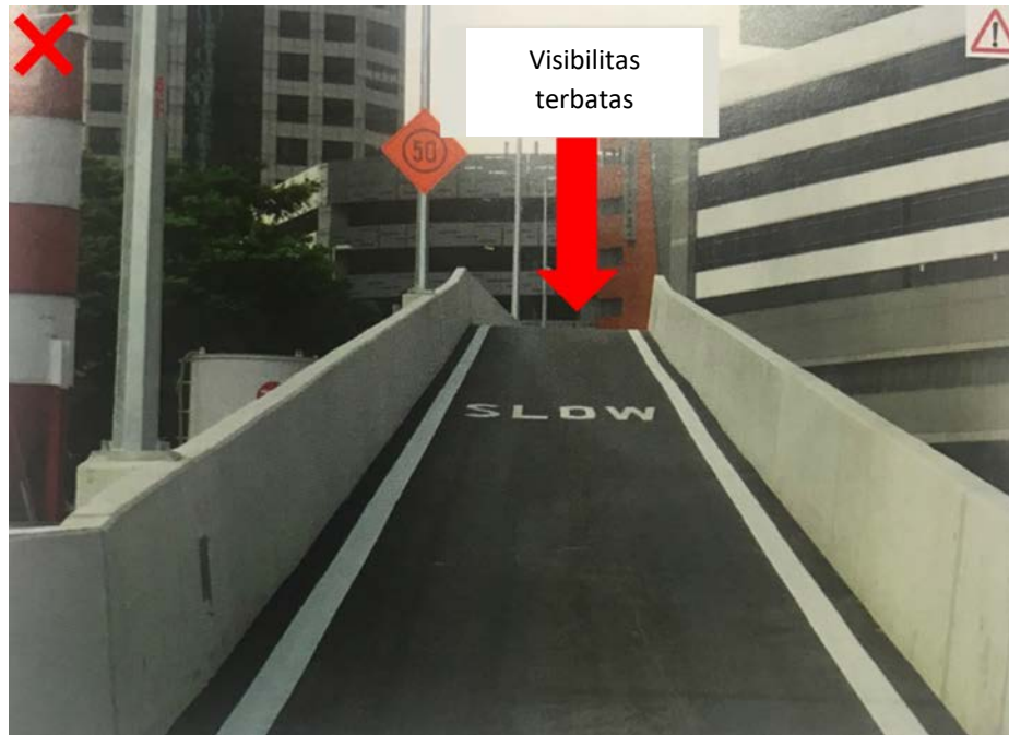
Foto 5.3. Visibilitas yang Tidak Memadai Sepanjang Kurva Vertikal, Singapura
