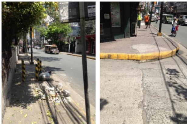
Figura 4.8: Calçada obstruída e baixo meio-fio em Manila.
