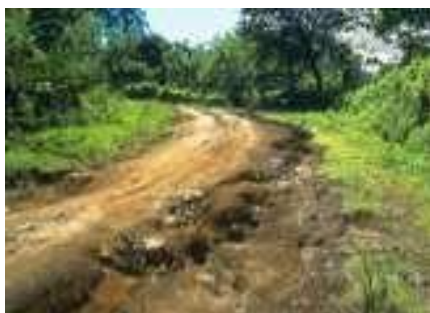
Figura 5.135: Estrada mal drenada com superfície irregular (fonte de sedimentos).
