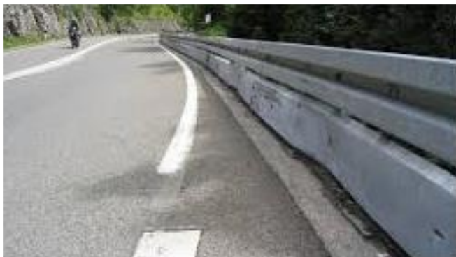
Figura 4.54: “Saia” adicionada a barreira metálica para proteger motociclistas - Vietnã.
