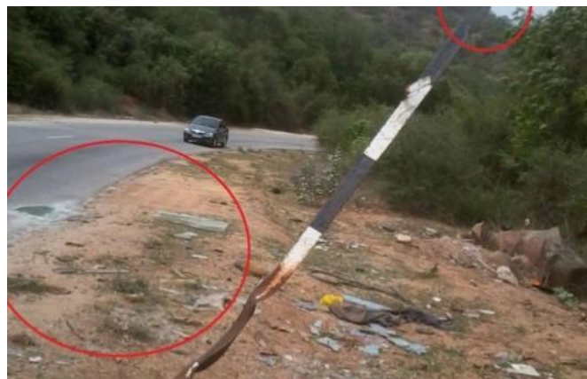
Figura 5.50: Placas quebradas e sem manutenção na Índia.
