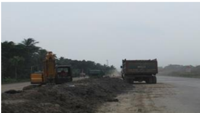
Figura 3.48: Obras em curso sem medidas de segurança temporárias – Bengala Ocidental.
