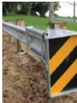
Figura 5.93 : Terminal de absorção de energia.
