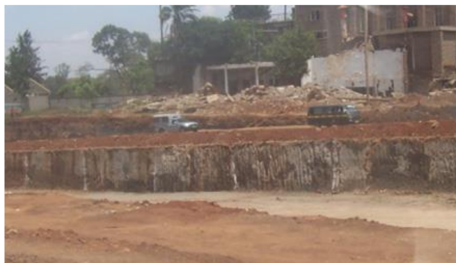
Figura 3.49: Obra de escavação desprotegida, e sem separação entre o canteiro de obra e o tráfego em geral, - Quênia.
