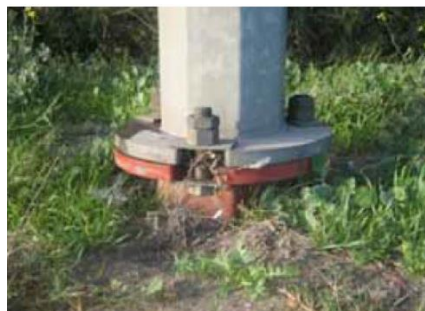
Figura 5.75: Coluna de iluminação com base deslizante adequada para vias de alta velocidade com pouca atividade de pedestres ou de estacionamento.
