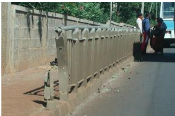
Figura 4.10: Grade de proteção/guardrail para pedestres mal conservado – Inspeção da Manutenção.
