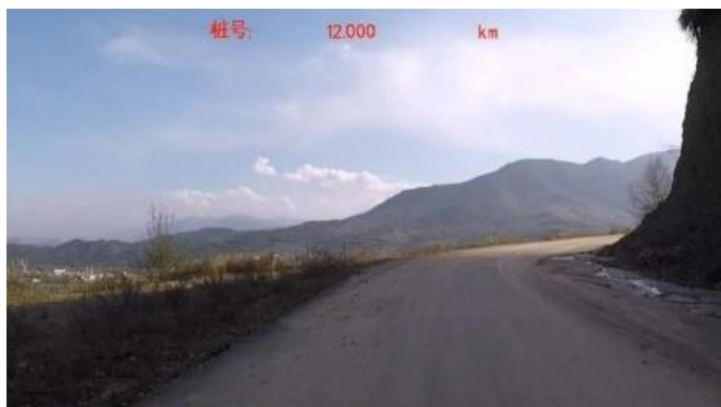
Figura 5.18: Delineamento insuficiente na curva.
