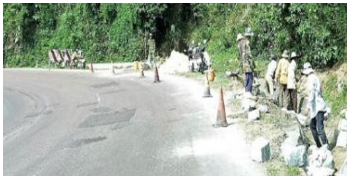
Figura 3.51: Total falta de equipamentos de proteção para os trabalhadores rodoviários ou da demarcação adequada da zona de trabalho.
