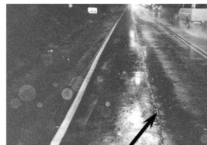
Figura 5.131: Borda da cobertura do pavimento causando retenção de água na superfície.
