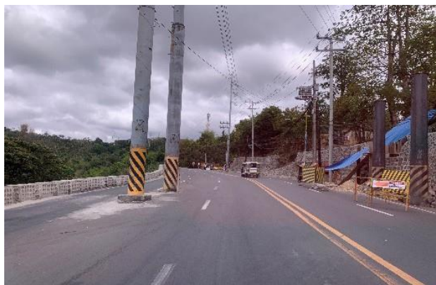
Figura 5.63: Via alargada, porém os postes não foram movidos – Filipinas.
