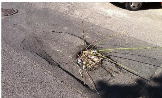
Figura 3.54: Superfície rodoviária mal conservada – Romênia.
