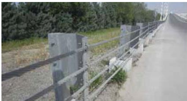
Figura 5.83: Barreiras flexíveis com postes demasiadamente grandes.
