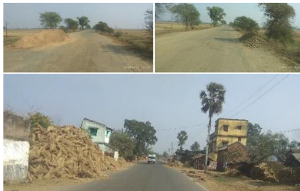
Figura 3.53: Material de construção empilhado e sem proteção ao longo da rodovia – Índia
