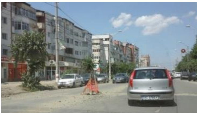
Figura 3.50: Construção sem proteção ou segregação da zona de trabalho e o tráfego geral - Roménia.
