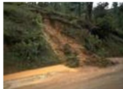
Figura 5.137: Deslizamento de terra bloqueando as valas para drenagem.
