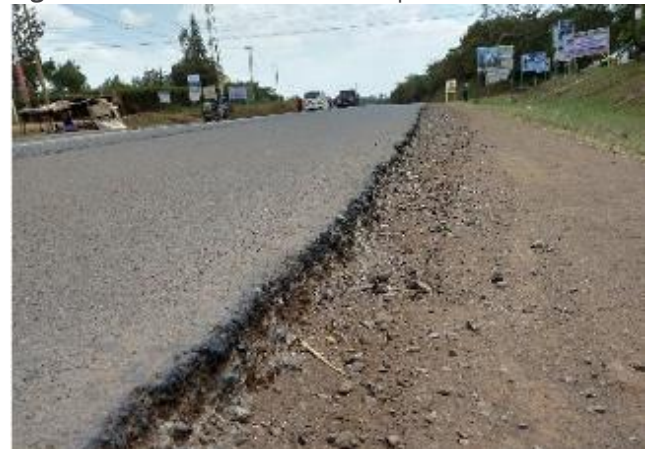
Figura 5.10: Desnível na borda do pavimento
