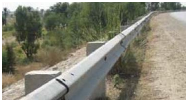
Figura 5.84: As unidades de trilhos se sobrepõem de maneira errada
